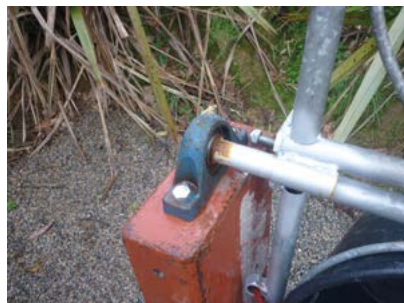
Roulement permettant le basculement du porte-seaux.
